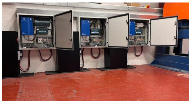
Figura 6. Sistema instalado en la sala de máquinas del King's College London. Fuente: Epic Power [7].
